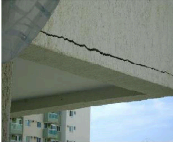
Figura 23 – Revestimento de argamassa na varanda rachado com risco de queda
