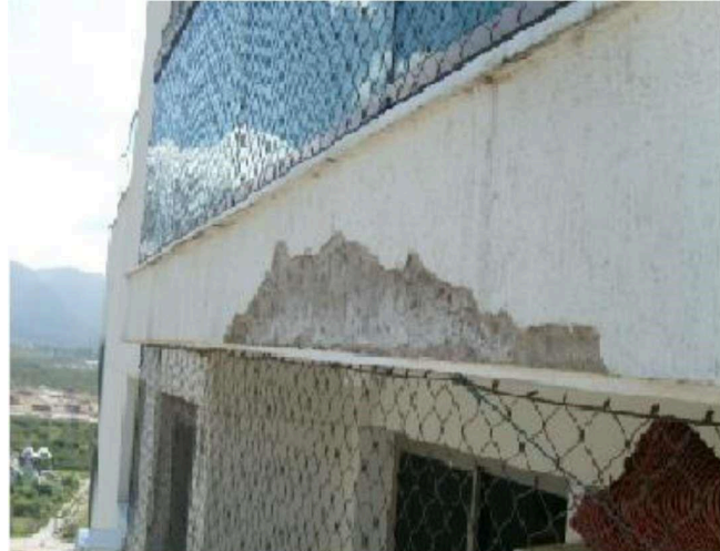
Figura 20 - Deslocamento de argamassa nas fachadas
