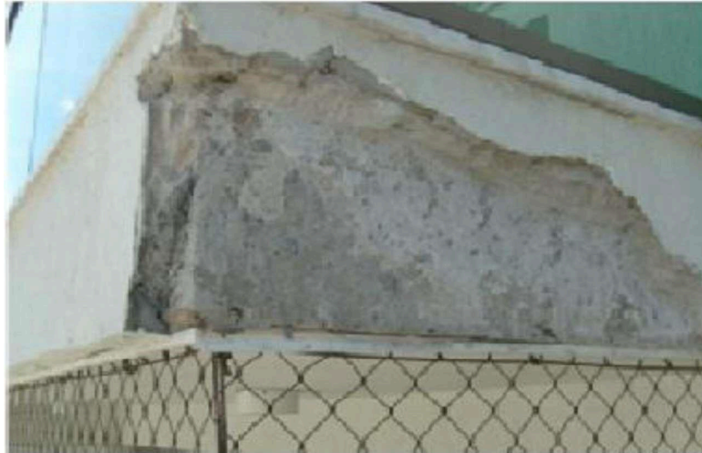
Figura 16 - Deslocamento de argamassa nas fachadas
