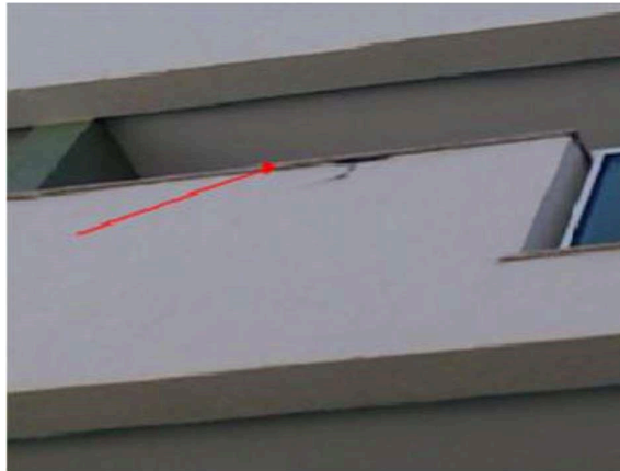
Figura 19 – Trincas na argamassa da fachada
