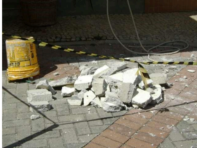
Figura 22 – Queda de revestimento de argamassa na varanda
