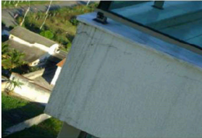
Figura 14 – Trinca no suporte do gradil da varanda
