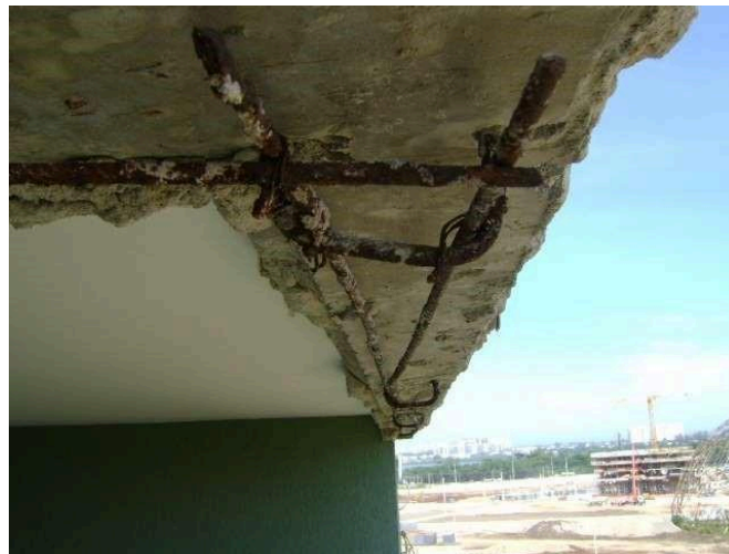
Figura 21 – Deslocamento de argamassa na varanda
